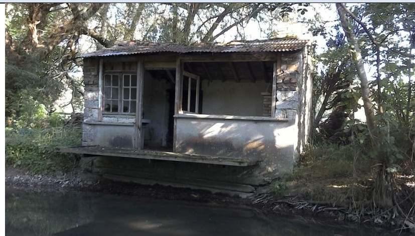
Petit bâtiment en bordure rive droite du Betz au droit de la parcelle cadastrale n°46 (≈ Profil topographique P8)
