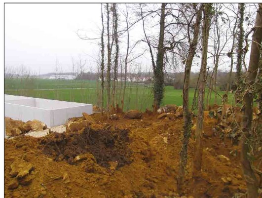
2015 - Proximité de Melun : Construction de STEP. Après coupe et enlèvement des bois, l'excavation du sol puis son occupation par des cuves bétonnées constituent un défrichage.
