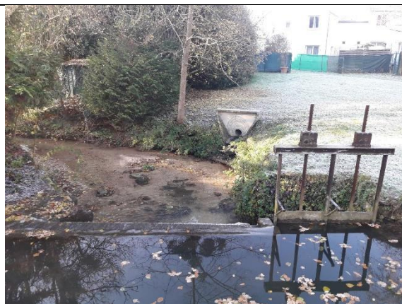
OH1 : Système de vannage et déversoir
