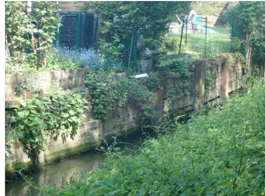
Exemple d'aménagement vieillissant sur la Beuvronne
