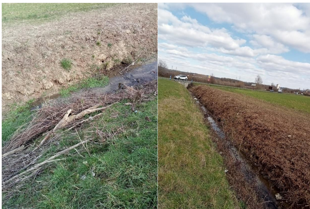
Figure 8 : Embâcle et déchets présent sur la vidange du Bréau, CIAE, 2023
