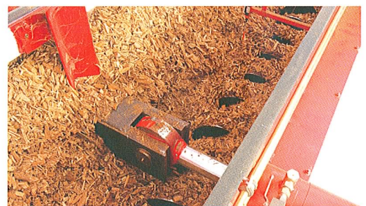
Désilage par racléur (piston) et alimentation de la chaudière par vis
