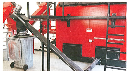
Chaudière bois de 0,6 MW avec déchargement automatique par vis
