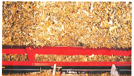
Alimentation en plaquettes par tapis à partir du silo
