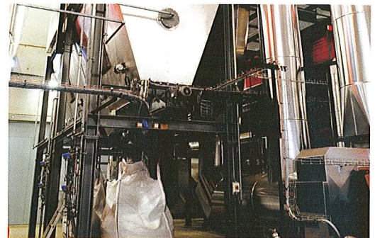
Filtre à manche avec récupération des poussières en big bag
