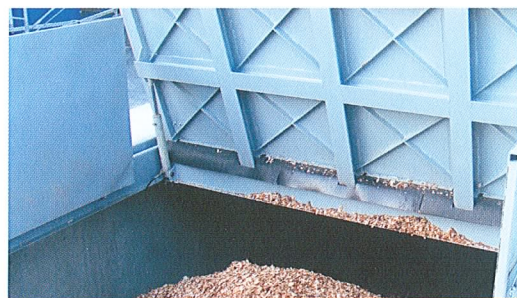
Silo enterré 250 m 3
