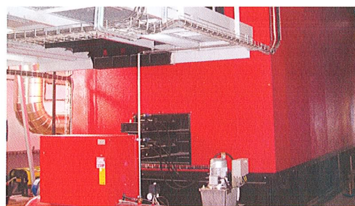
2 chaudières bois 5 MW
