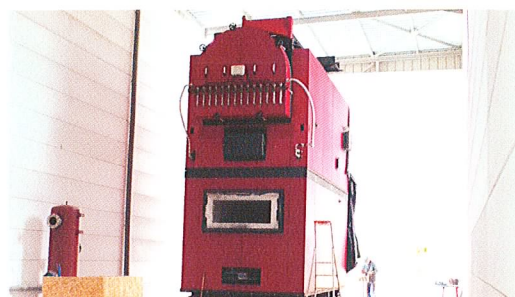
2 Chaudières bois de 3 MW
