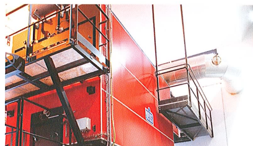
Chaudière bois 2,5 MW
