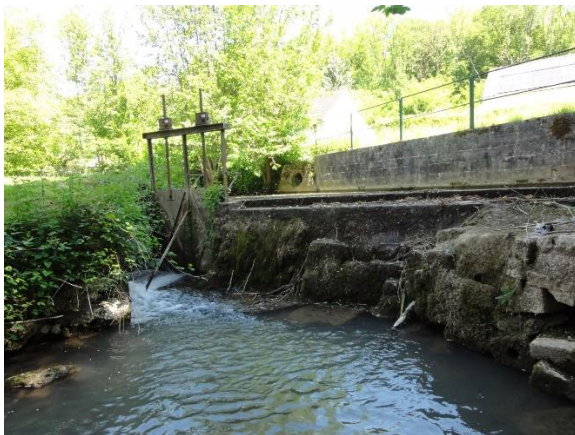
Système de vannage et déversoir(OH1)
