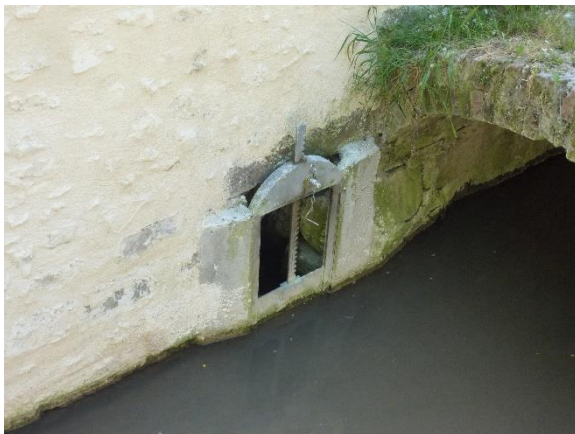
Prise d'eau de la maison de retraite
