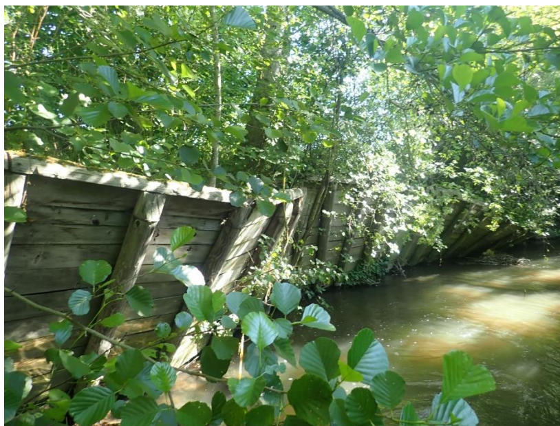
Figure 12 : Protections de berges menaçant de s'effondrer (SEGI,05/20)
