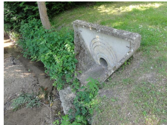
Rejet eau pluviale en aval de l'OH1
