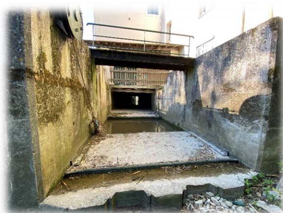
Figure 16 : Clapet du canal usinier
