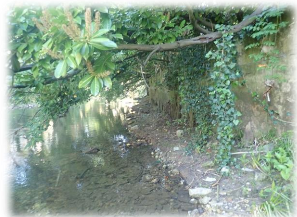
Figure 34 : Banquette exondée en pied de mur
