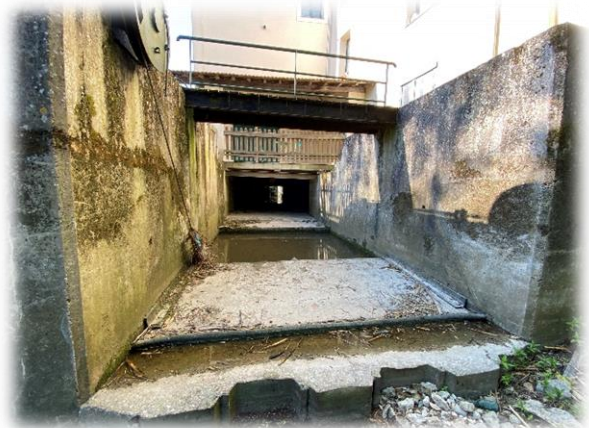
Figure 65 : Clapet du canal usinier
