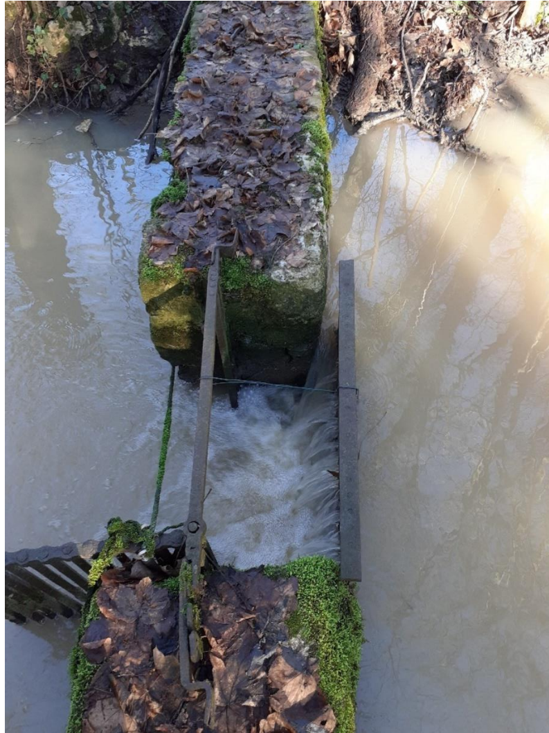
Figure 7-20. Vue de la prise d'eau OH40 obstruée en amont du bief d'alimentation du plan d'eau de « La Nosaye »
