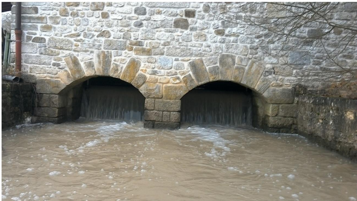
Figure 7-5. Vue depuis l'aval de la vanne desservant le bras inférieur du Lunain
