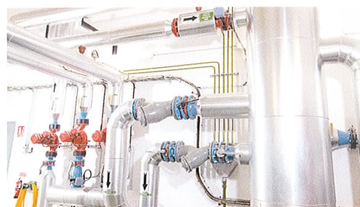
Circuit hydraulique de distribution de la chaleur
