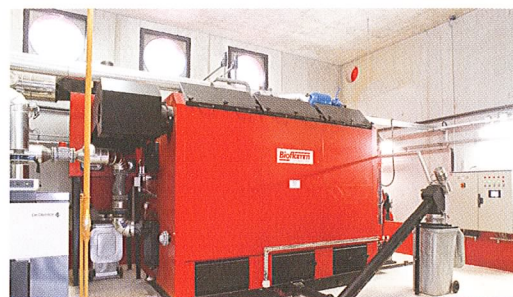
Chaudière bois 1,25 MW avec décendrage automatique
